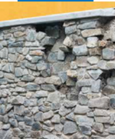
Стена из камня с об- рушенными участками
